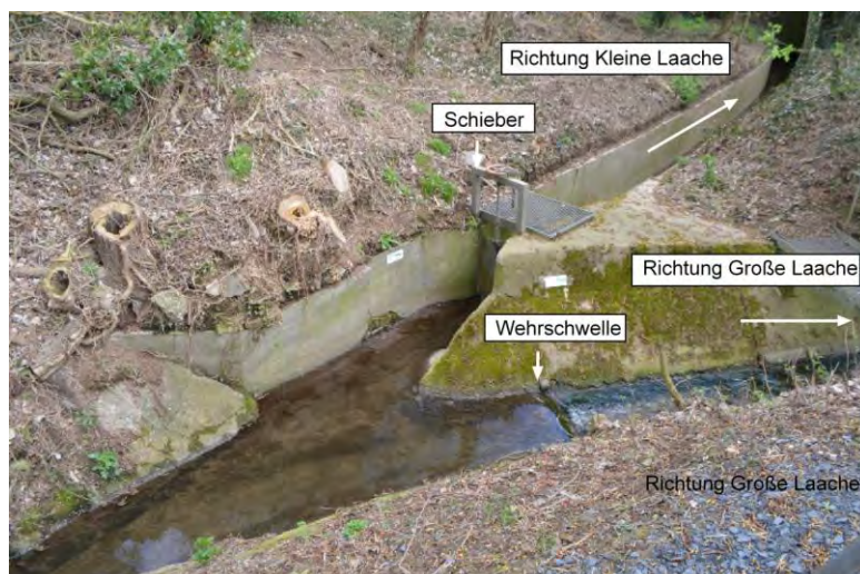
Abb. 4.4-2: Aufteilungsbauwerk an der Pletschmühle 07. April 2016
