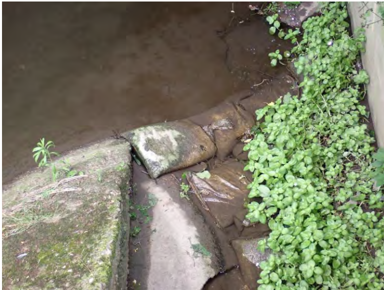
Abb. 4.4-3: Aufteilungsbauwerk Pletschmühle, Sandsäcke am Abzweig zum Langer Weiher 28. Juni 2024
