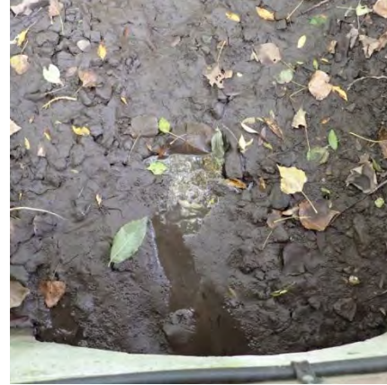
Abb. 4.4.1-8: Schluckloch hinter Brücke 7. Oktober 2024
