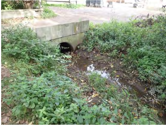
Abb. 4.4.1-7: Wasser vor Brücke 7. Oktober 2024
