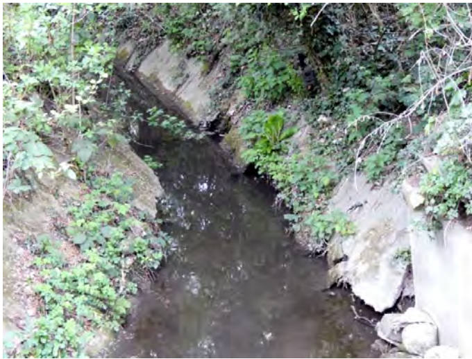
Abb. 4.4-1: Pulheimer Bach oberhalb des Aufteilungsbauwerkes an der Pletschmühle; Schäden durch Wurzeldruck 10. April 2025
